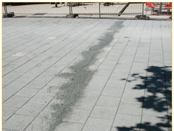
Nach der Sicherung hält der Belag
