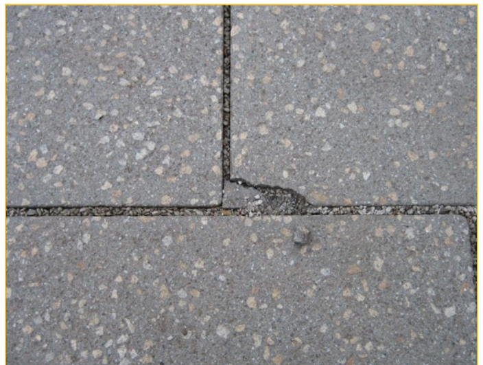
Schadensbild: Verschiebungen und Abplatzungen
